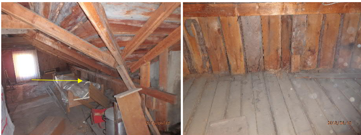
Kuva 6. 1970-luvun laajennuksen kohdalla jäävään matalaan ullakotilaan ei ollut lainkaan tarkastusmahdollisuutta. Puuosissa näkyvien kosteusjälkien perusteella on syytä epäillä, että loivan laajennusosan lappeen liittymän kautta on tapahtunut vesivuotoja ennen nykyisen peltikaton asentamista.
