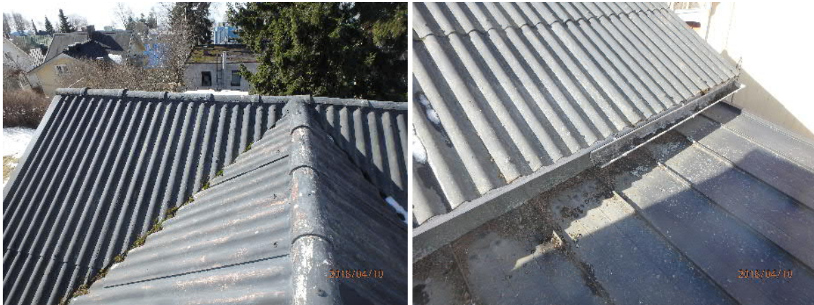
Kuva 7. Harjakatoissa on 1970-luvun asbestipitoiset varttikatteet. 1970-luvun laajennuksen kate on uusittu 2000-luvun aikana profiilipeltikatteeksi. Kate on kuitenkin loivempi kuin ko. katetyypin käyttöohjeet sallivat.
