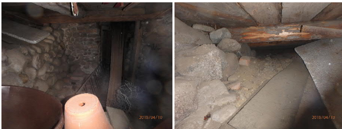
Kuva 3. Vanhimpien osien alapuolella oli matalia kellaritiloja. Kellaritilojen vierestä jatkui matalia välitiloja puurakenteisen alapohjan alla. Umpeen muurattujen sokkeliensa takia tiloissa ei ollut tainkaan tuuletusta.
