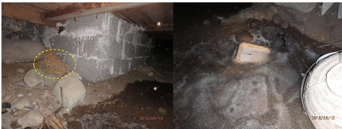
Kuva 4. Eteisen alla olevaan ryömintätilaan ei päästy sisään luukun jäätyksen takia. Kameran kuvissa erottuu kuitenkin pesuhuoneen kohdalla muurattujen betoniharkkojen vieressä alapohjasta valunutta purueristettä (keltainen ympyrä) sekä ryömintätilan pohjalla runsaasti jäässä olevaa vettä.
