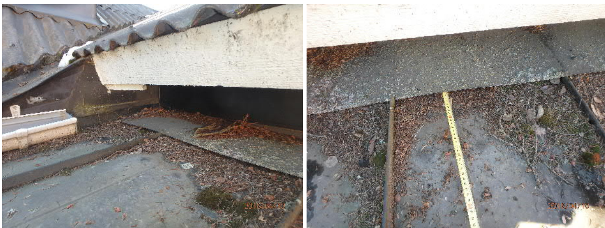
Kuva 8. 1970-laajennuksen profiilipeltikate oli suosituksia loivempi. Vanhan räystään alla olevan limiliitoksen takia katon vedenpitävyys on pelkästään aluskatteen varassa.
